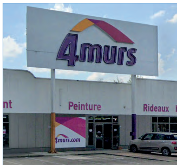
Scellée au sol illégale
